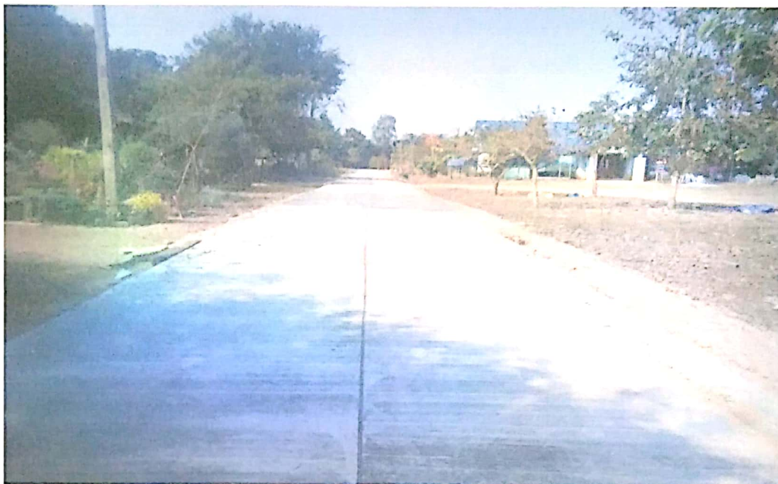
ภาพถ่ายก่อสร้างถนนคอนกรีตเสริมเหล็กสายป้องกัน หมู่ที่ ๕ บ้านนาตาล
